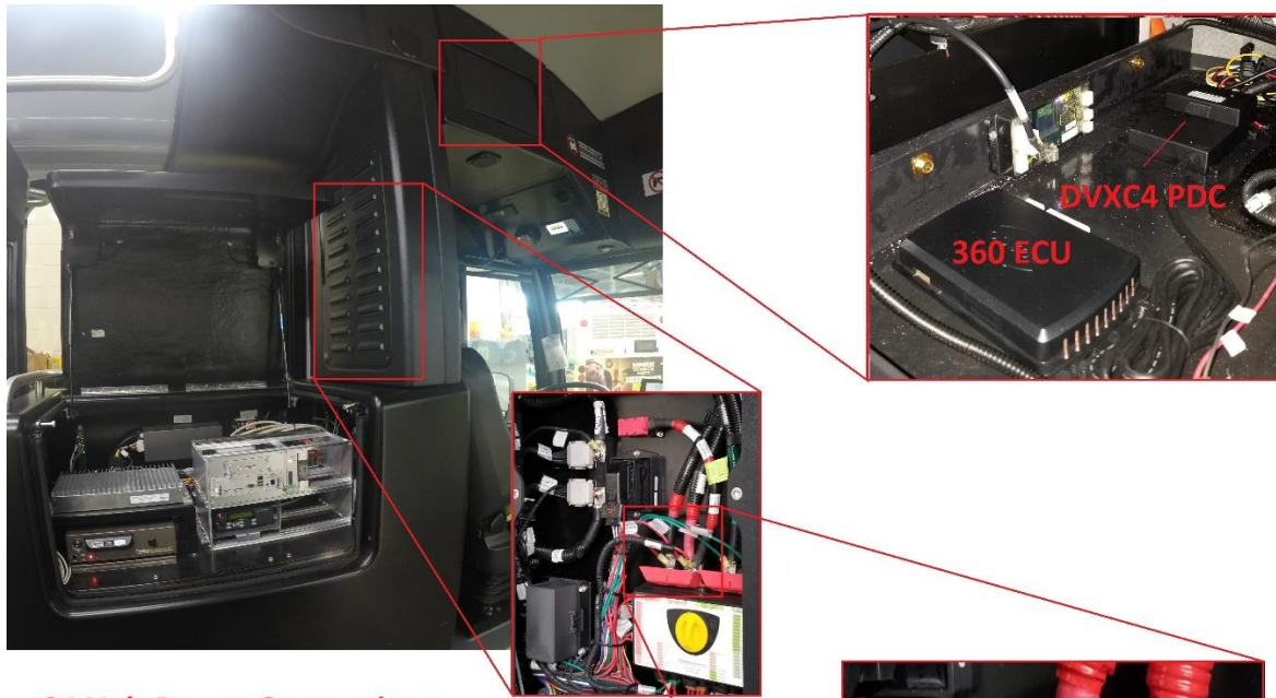
24 Volt Power Connections
